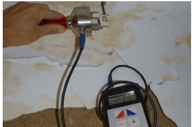
Abb. 35: Messung nach Wasserschaden
