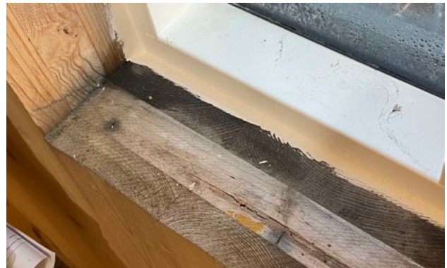
Abb. 32: Ungeschütztes Hirnholz im Fensterbereich
