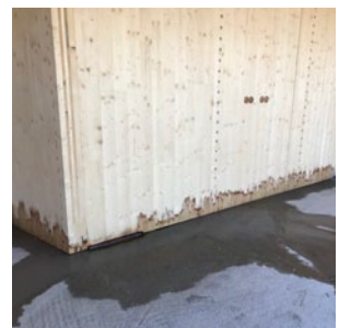
Abb. 31: Ungeschützter Wandsockel auf Betonplatte
