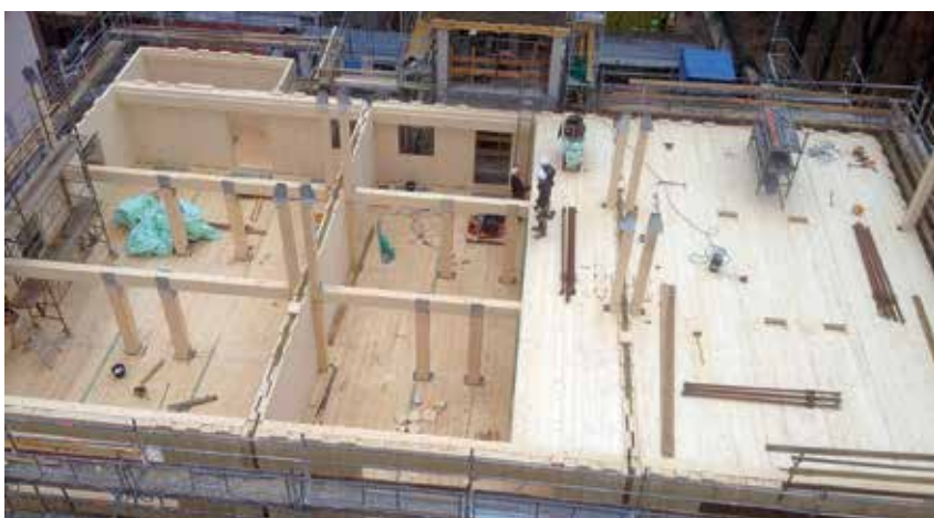
BSP-Wände und -Decken kombiniert mit Stützen und Trägern in den mittleren Längsachsen bilden das Tragwerk.
