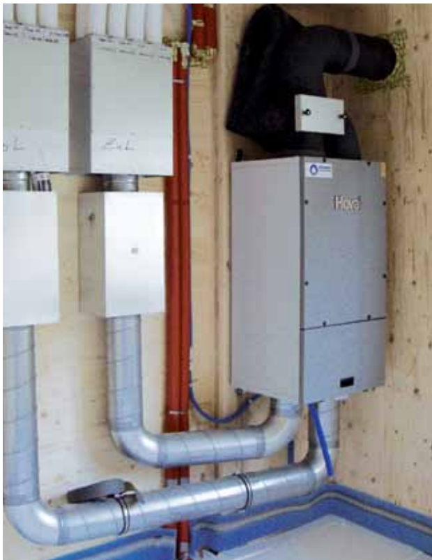
Abb. 13: Montage einer Lüftungsanlage an einer KLH-Wand [mit freundlicher Unterstützung durch Eberle • denkfabrik •, Dornbirn, Österreich]
