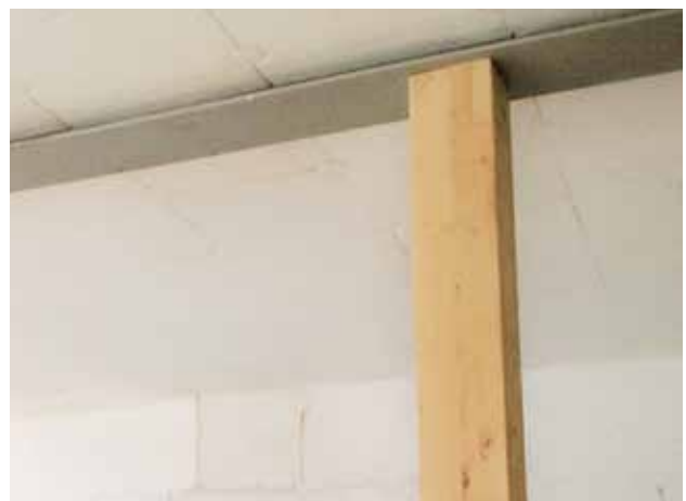
Abb. 6: Eine lineare Wärmebrücke im Entstehen. Wird der Stahlträger nicht noch in die Dämmung eingebunden, so ist Tauwasserausfall vorprogrammiert
