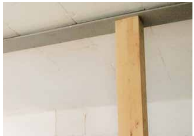
Fig. 6: Aparición de un puente térmico lineal. Si el soporte de acero no va a ser integrado en el aislamiento, lo más probable es que se produzcan daños por condensación
