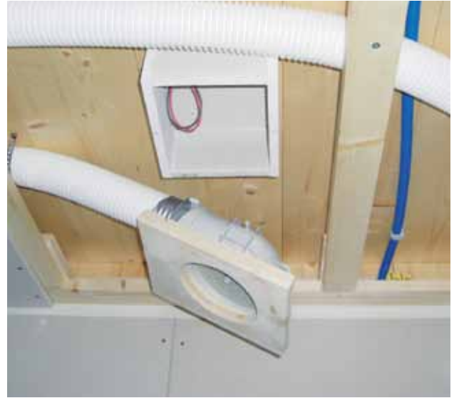
Fig. 14: Colocación de las tuberías detrás de un falso techo. Sistema HOVAL [por gentileza de Eberle • d e n k f a b r i k •, Dornbirn, Austria]
